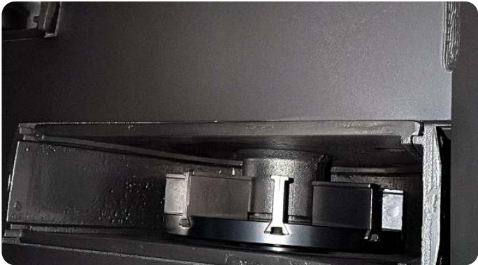
Roue de turbine vue depuis l'intérieur de la chambre.
