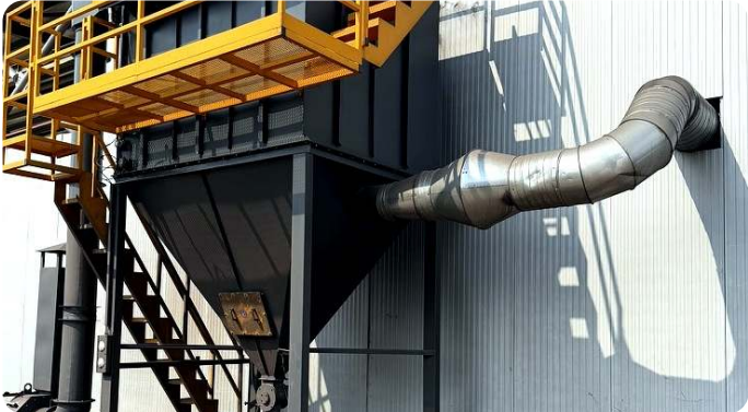
Dépoussiéreur à décolmatage automatique, avec écluse rotative.
