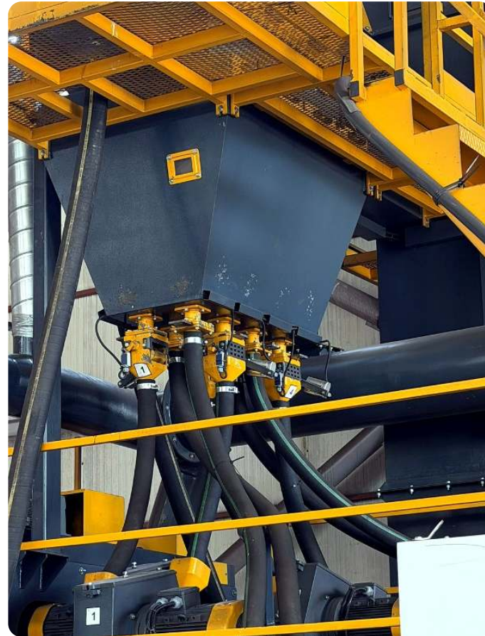
Sous la trémie, une vanne d'abrasif par turbine : la distribution de grenaille est pilotée individuellement.
